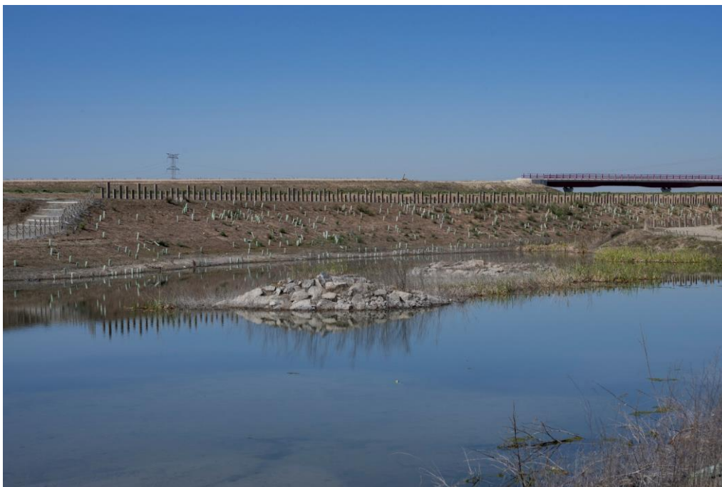
Figura 30. Vista de la balsa grande de la Fase 2. Al fondo talud norte, que presenta gran mortalidad por inundación.
