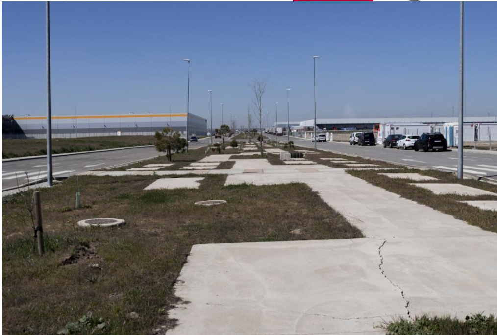
Figura 47. Mediana aneja a la nave de Amazon, puede seguir el mismo tratamiento que la B12. Se inició hace dos campañas y falta ser terminada.
